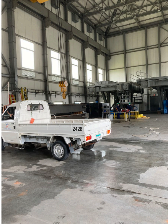
Encharcamientos y grietas en el piso
