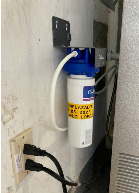
Filtro de agua reemplazado recientemente
