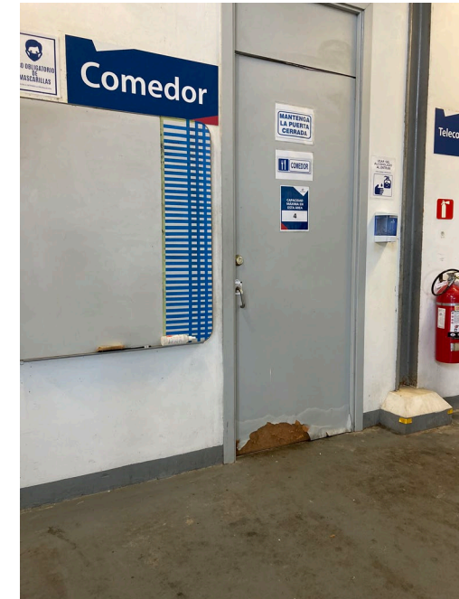
Infraestructura con necesidad de mantenimiento por problemas de humedad
